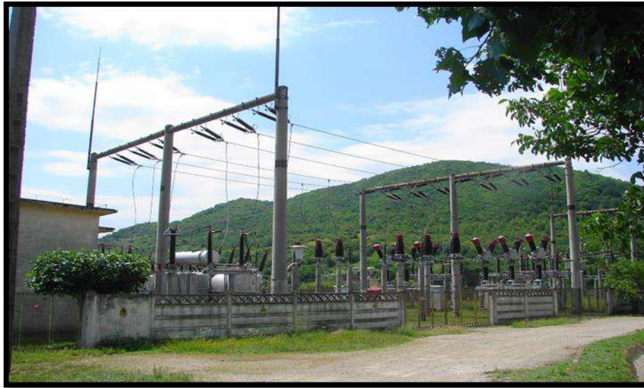
Stația de transformare P.T.110
